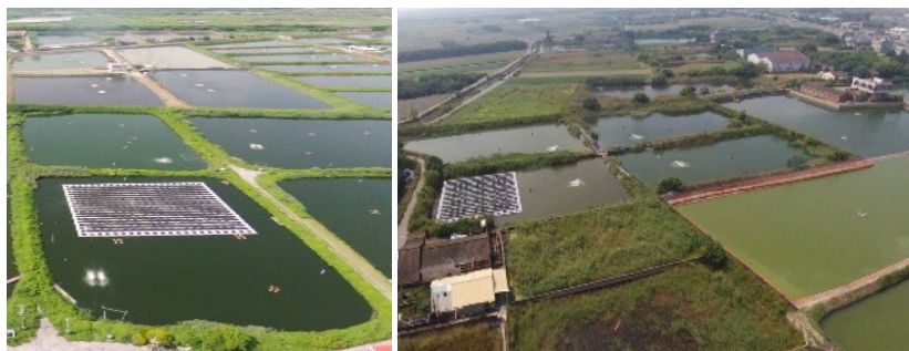
圖 3-1-1 浮筏型太陽光電設施結合白蝦養殖試驗 (左:臺南學甲養殖試驗池;右:雲林口湖養殖試驗池)
